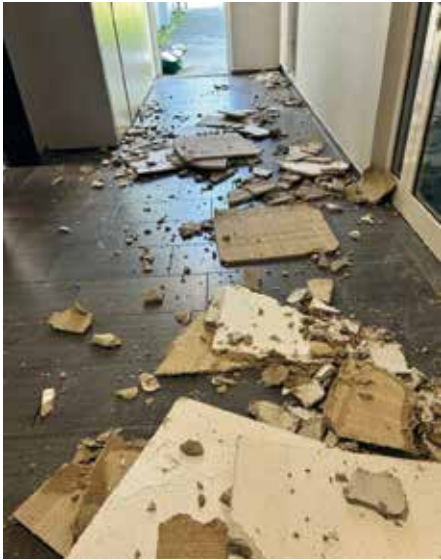
Die durchnässte Decke im Flur fiel noch am Abend herunter
